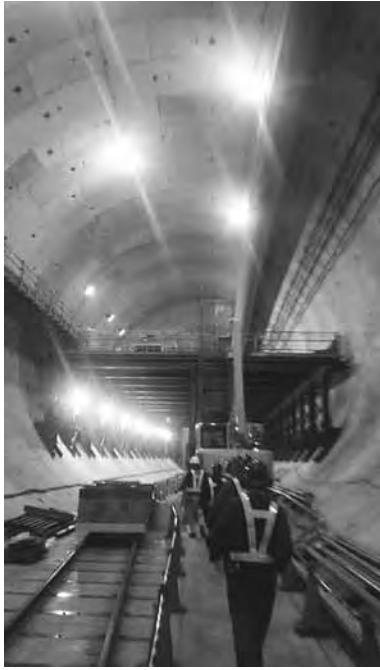
【写真2】外環・東名ジャンクション工事現場：大泉方向に掘削中のトンネル内部
